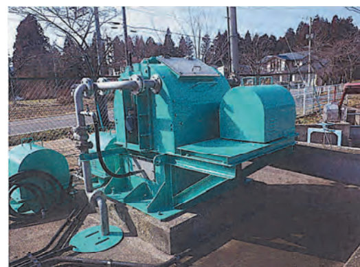
維持管理適正化事業で整備された金矢除塵機
