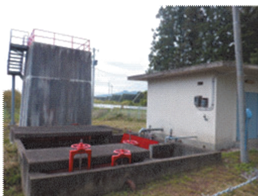
北湯口1揚水機(北湯口地内)
