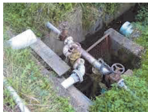
照井揚水機(東十二丁目地内)
