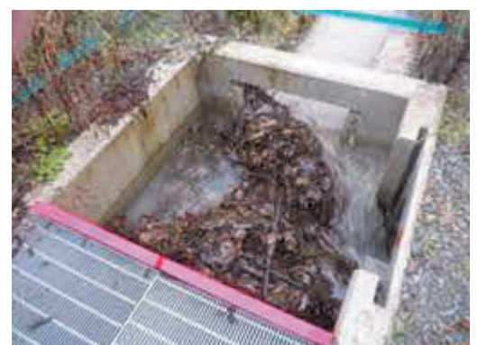
ゴミ詰りにより上流部越流
