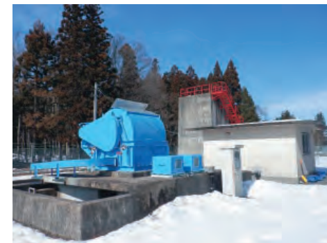
鍋倉2除塵機 (サイクロ減速機更新 他)
