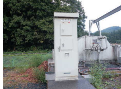
上：大畑2揚水機電動弁 下：鍋倉除塵機操作盤
